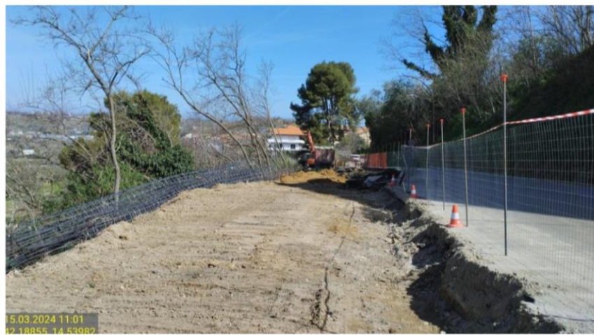
PNRR - Missione 2 Componente 4 Sub-investimento 2.1b) Sistemazione frana SP 130 "Torino di Sangro - Casalbordino" al km 0+900
